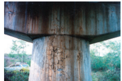
AARによるひび割れ
